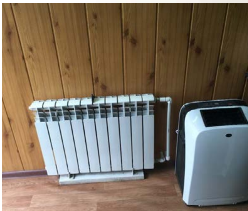
Рис. 5. Система отопления и кондиционирования в кабине
