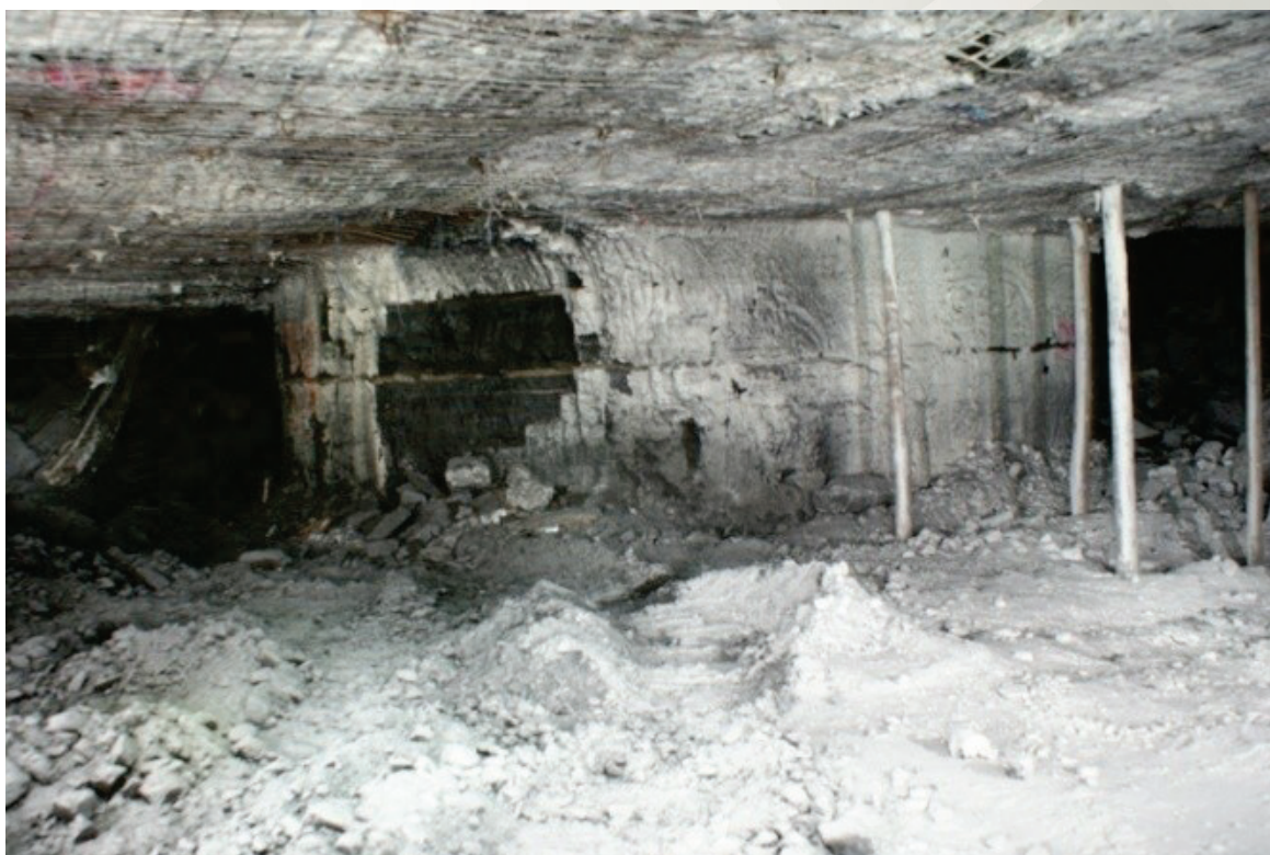
Рис. 14. Состояние целика после отработки
